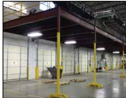
20'W x 250'L X 14'H Steel I-Beam Mezzanine
